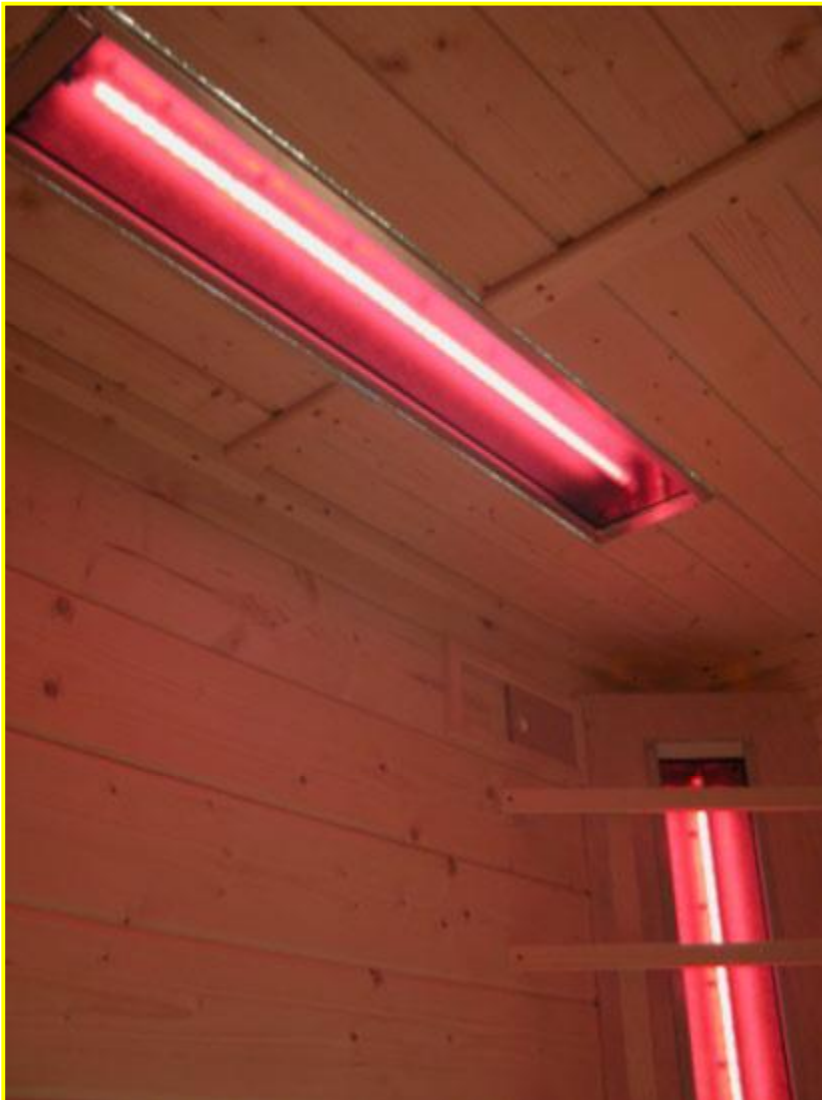
Eingeschalteter Decken- und Eckenfluter
