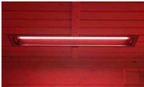
Eingeschalteter Deckenfluter 750 Watt
